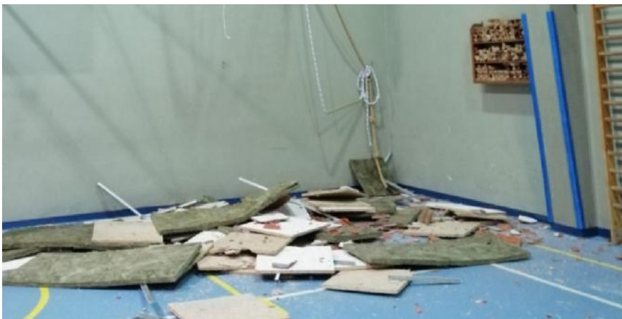
Palestra delle medie Il materiale crollato dal controsoffitto mentre le medie erano per fortuna chiuse
